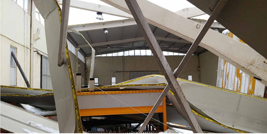
Şekil 1. İş yerinin çatısı çöktü[4, 2014].
